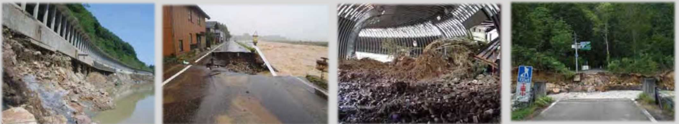
写真：左から、被災した国道459号師走スノーシェッド（新潟県阿賀町師走）、被災した国道289号（新潟県三条市荒沢）、流出した国道352号金泉橋（新潟県魚沼市下折立）、被災した国道253号スノーシェルター（新潟県南魚沼市余川）
